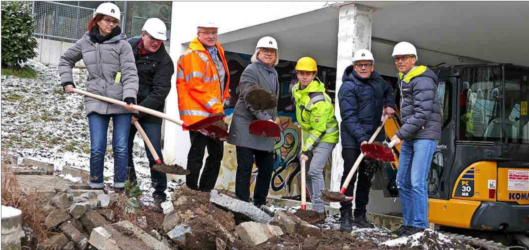
Es kann losgehen: (von links) Architektin Katharina Teute, Bauamtsleiter Jörg Schmidt, Bürgermeister Peter Palme, Architekt Richard M. Stoll, Christopher Neumann (Firma Schmidt, Bernau), Bauleiter Rolf Hegi und Schulleiter Norbert Asal beim Spatenstich.
